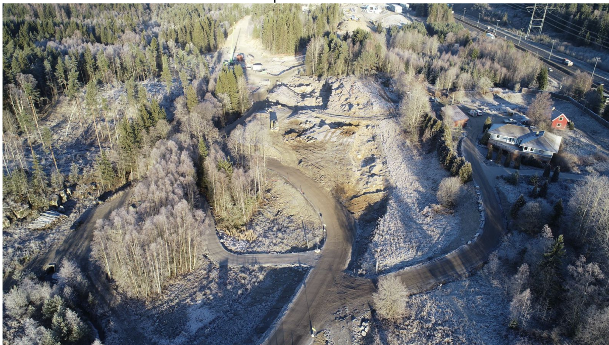
Bilde 3: Rivearbeidene er ferdigstilt, og det er klargjort for videre arbeid med adkomstveien.
