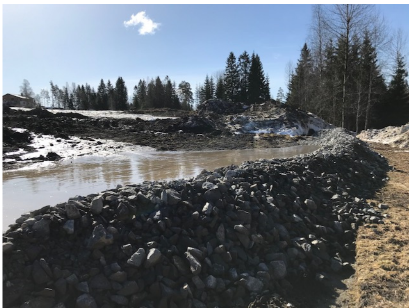
Bilde 2: Infiltrasjonsbasseng for rensing av overvann
